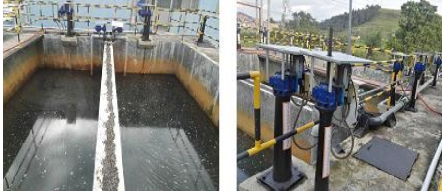
Figura 9. Filtros y sus válvulas automáticas para lavado
