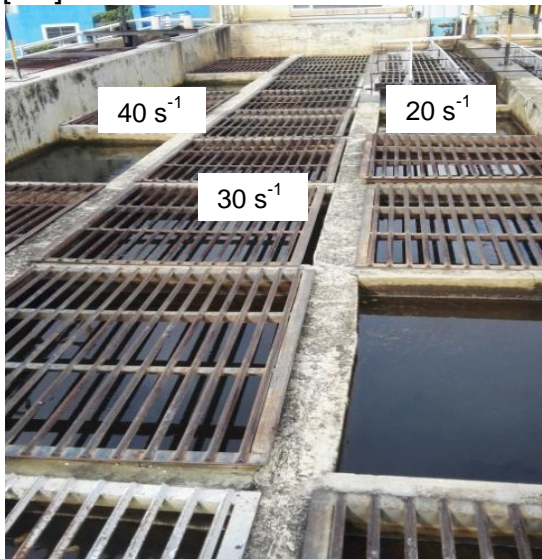
Figura 7. Floculadores de la planta EAF con gradientes de 40, 30 y 20 \text{ [1/s]}
