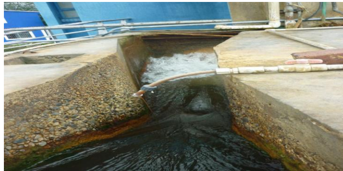
Figura 5. Suministro Sulfato de Aluminio Tipo B y Canaleta Parshall
