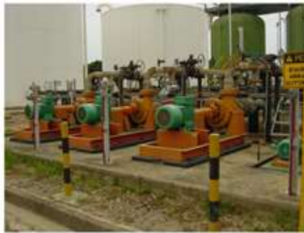
Imagen 4. Bombas booster en la estación de bombeo PS1 de Caño limón
