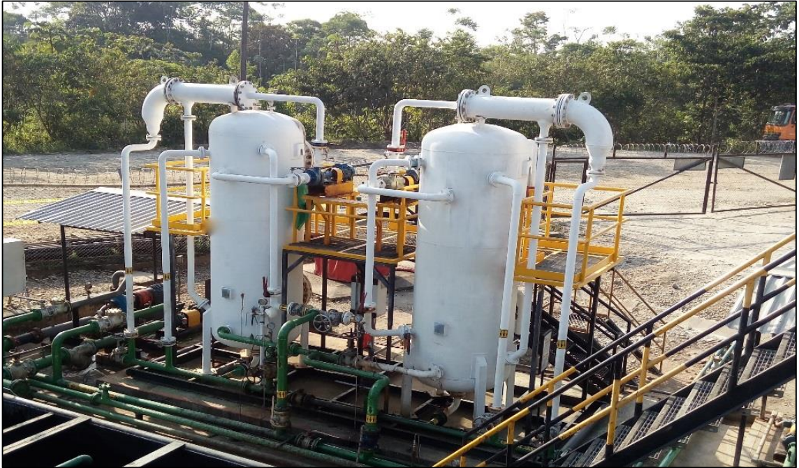
Figura 9. Filtros de cáscara de nuez Estación C.
