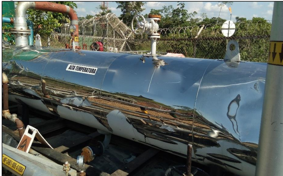
Figura 3. Intercambiador de Calor HE-404 A.
