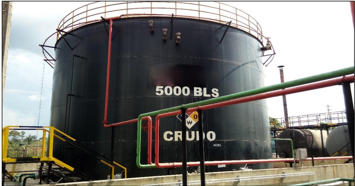
Figura 7. Tanque de almacenamiento de crudo TK-406 C.
