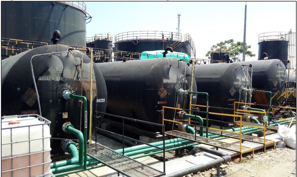
Figura 8. Tanques de almacenamiento de agua Estación C.
