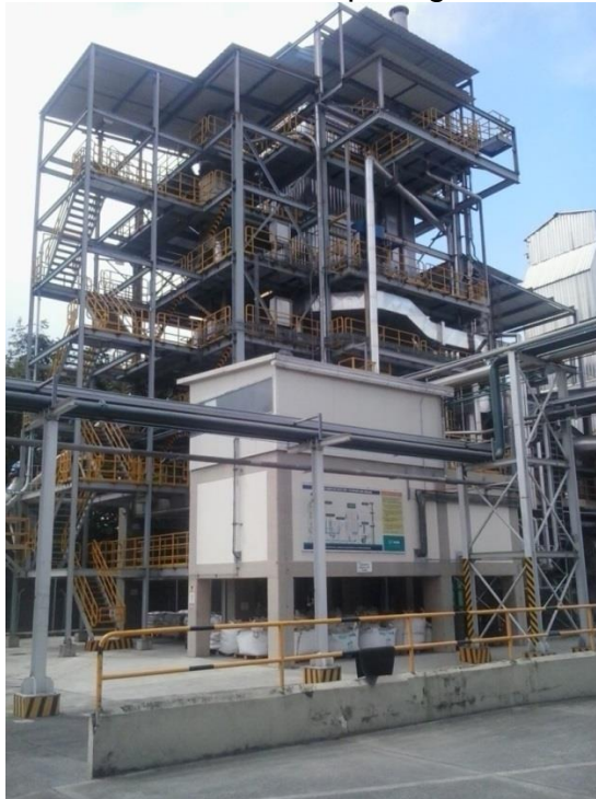
Figura 12. Caldera acuatubular para generación de vapor.
