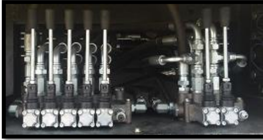
Foto 21. Consola de operación del mástil.
