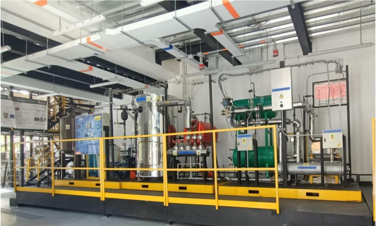
Figura 15. Unidad de Planta Térmica
