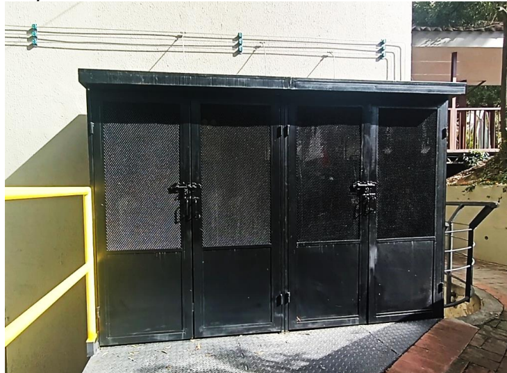
Figura 8. Almacenamiento de Cilindros con Gases Especiales
