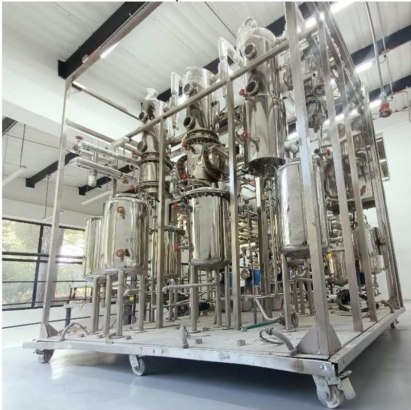
Figura 19. Unidad de Tren de Evaporadores
