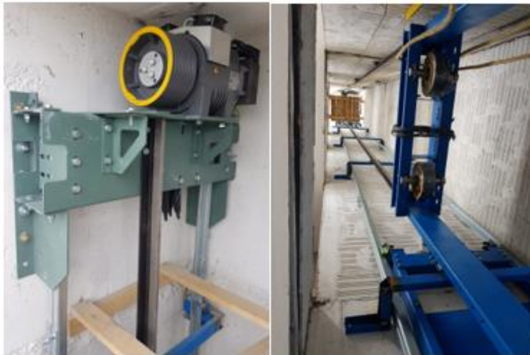
Nota. Fotografía del sistema mecánico del ascensor WS-930
