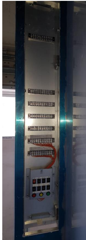
Nota. Fotografía del panel de control del ascensor WS-930
