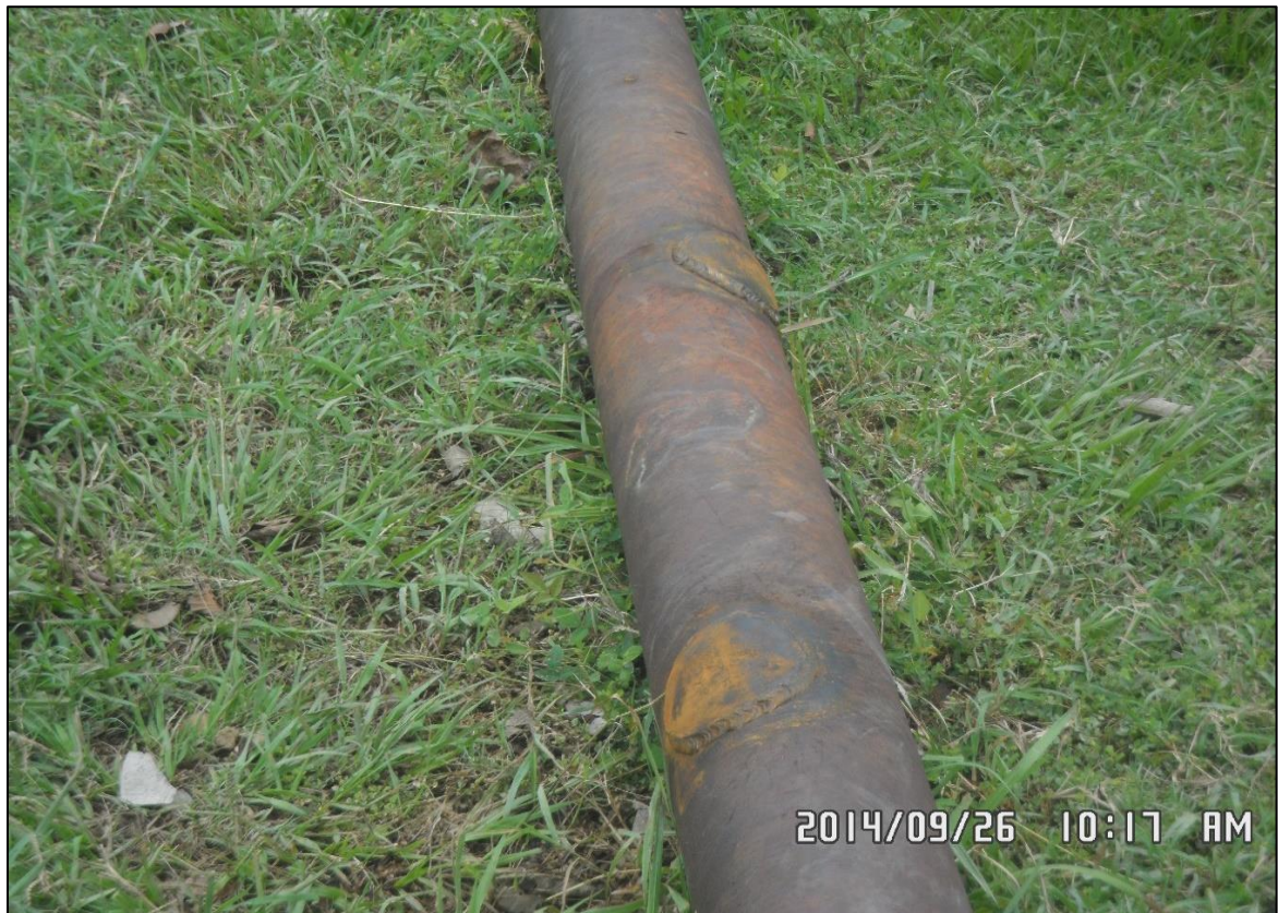
Ilustración 4. Estado de la tubería Campo Palagua.
