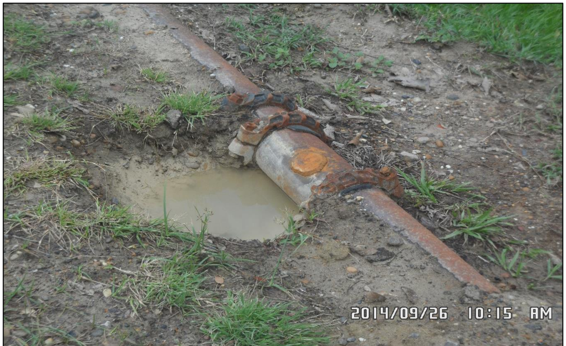
Ilustración 6. Estado de la tubería Campo Palagua.
