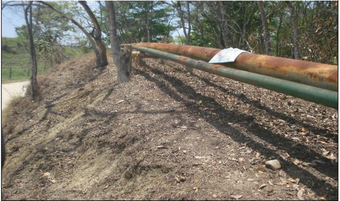
Ilustración 5. Estado de la tubería Campo Palagua.
