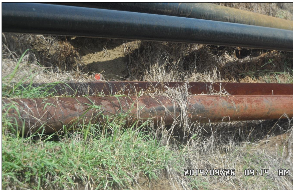
Ilustración 7. Estado de la tubería campo Palagua.
