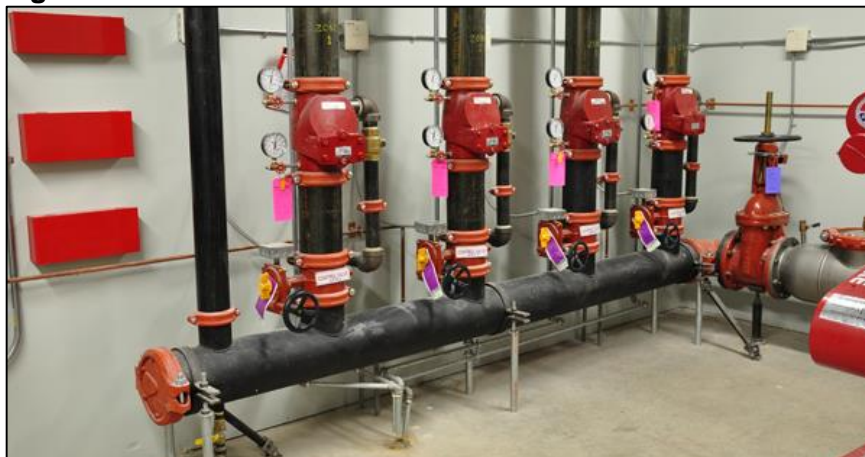
Figura 44. Manifold a salida de bomba.
