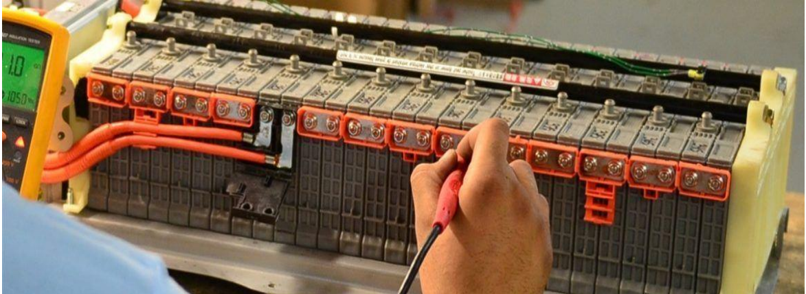
Figura 41. Inspección de voltaje en el banco de baterías
