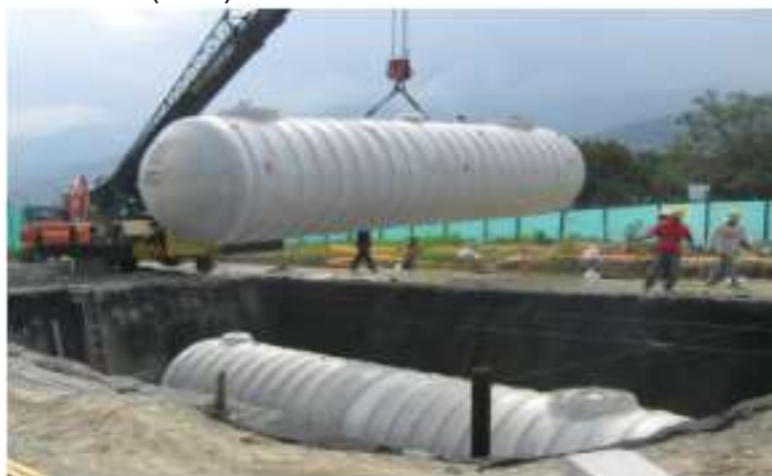
Figura 10. Tanques de poliéster reforzado con fibra de vidrio (FRP)
