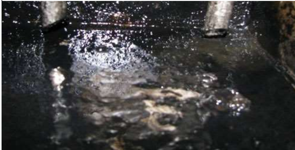
Figura 7. Resultado del proceso de corrosión y degradación en tanques de almacenamiento de combustible
