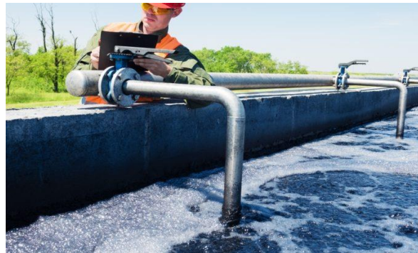
Figura 3. Tanques de aireación en aguas residuales
