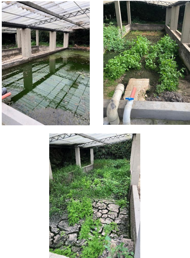
Imagen 1 Lecho de secado con lodo residual
