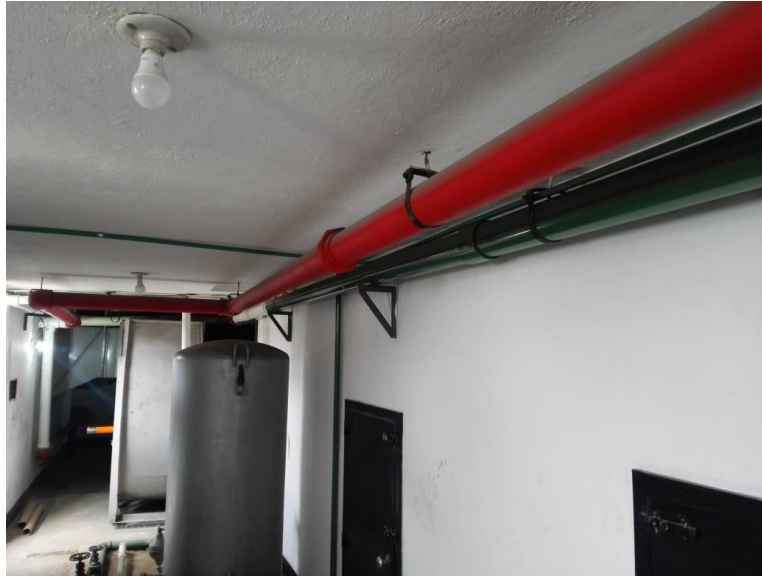
Figura 12. Red de tuberías y conductos de la condensadora
