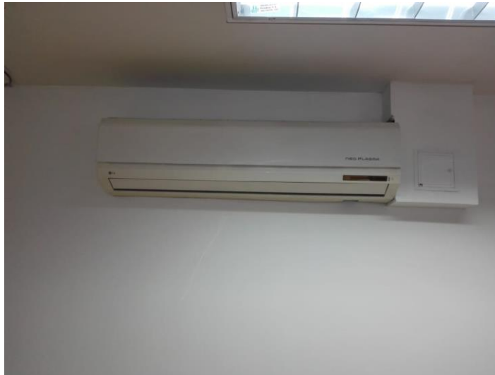
Figura 9. Unidad interior instalada
