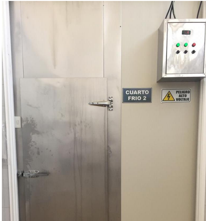
Figura 12. Cuarto frío de almacenamiento 2
