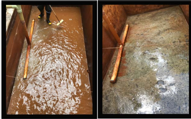
Ilustración 21. Tanque final controlador de pH
