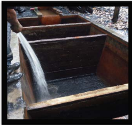
Ilustración 18. Tanque de sedimentación de lodos
