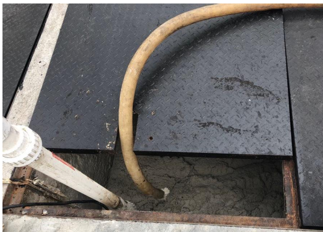
Figura 13. Tanque lodos fisicoquímicos.
