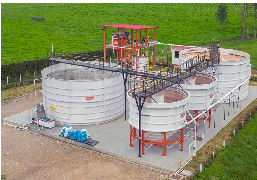
Figura 11. Planta de tratamiento de aguas residuales empresa láctea municipio de Cogua.
