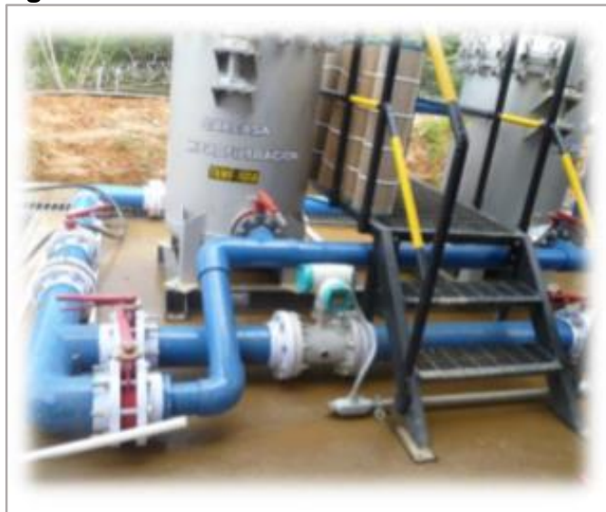
Figura 14. Medidor de Caudal.
