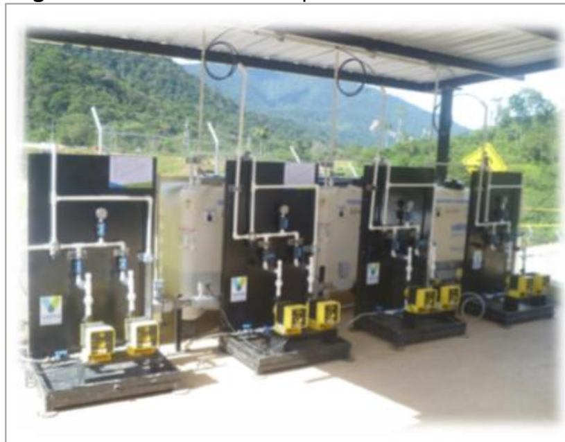
Figura 15. Dosificadores de químicos
