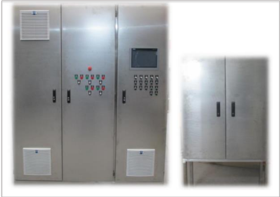
Figura 16. Tablero de Potencia y control
