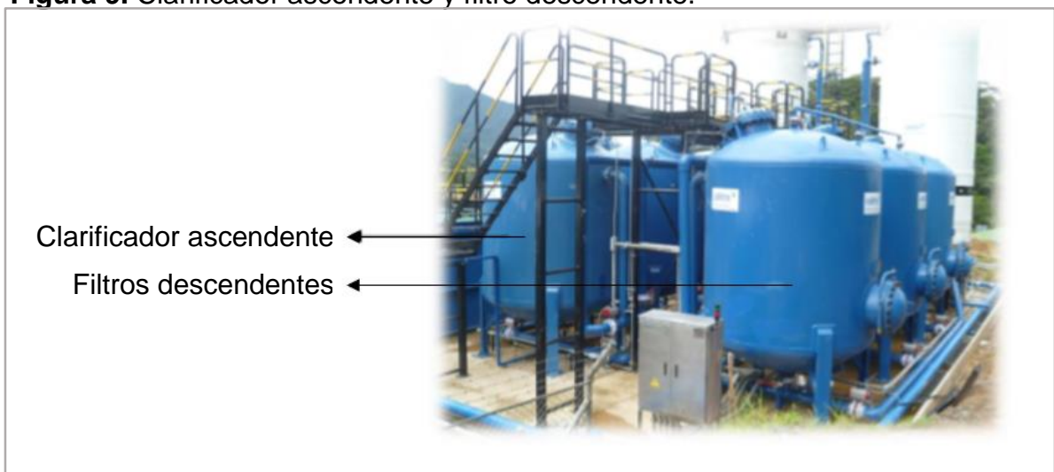
Figura 9. Clarificador ascendente y filtro descendente.
