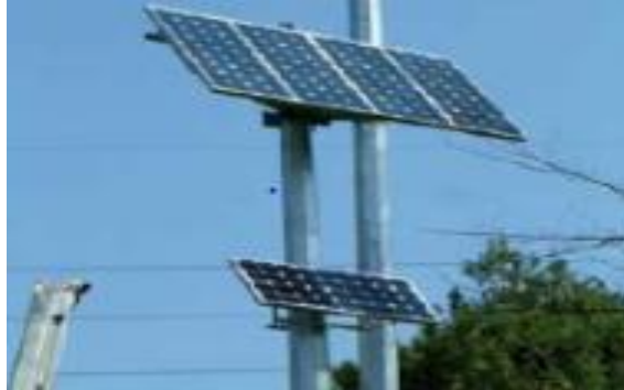
Figura 14. Instalación solar sobre mástil
