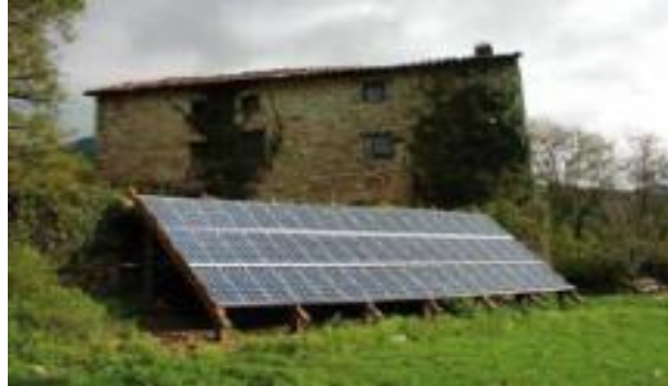
Figura 13. Placa solar anclada al suelo
