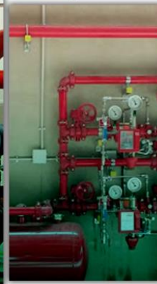
Sistema de extinción a base de espuma
