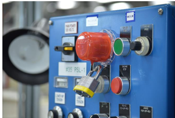
Imagen 137. Evitar arranque de la maquina
