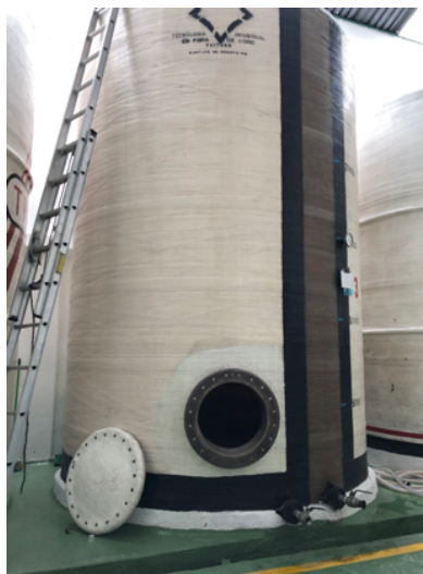
Figura 2. Tanque de descube
