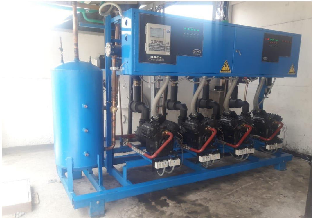
Figura 14. Rack de compresor R-507.
