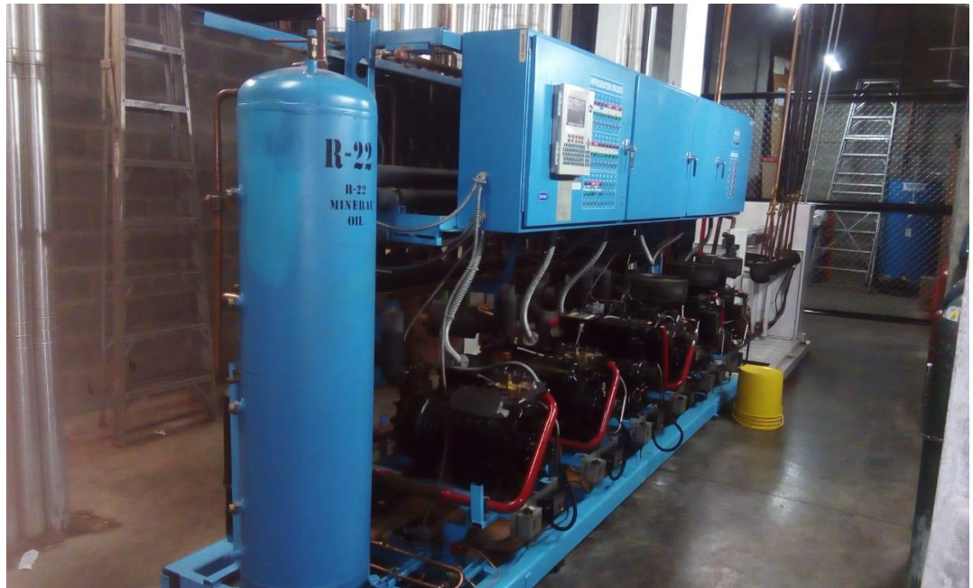
Figura 13. Rack de compresor R-22.
