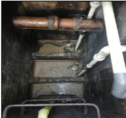
Figura 4. Trampa de grasa casino.
