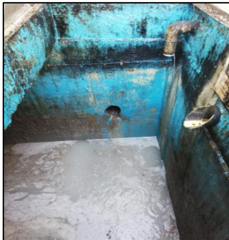
Figura 7. Tanque de igualación
