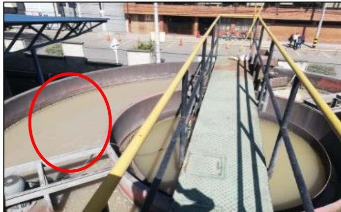
Figura 12. Tanque de aireación.
