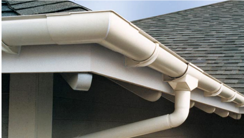
Figura 12. Tubería y canaleta.
