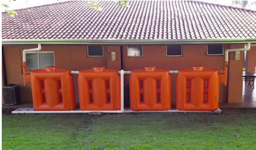
Figura 1. Tanques exteriores modulares.
