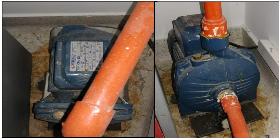
Ilustración 2. Bomba de agua
