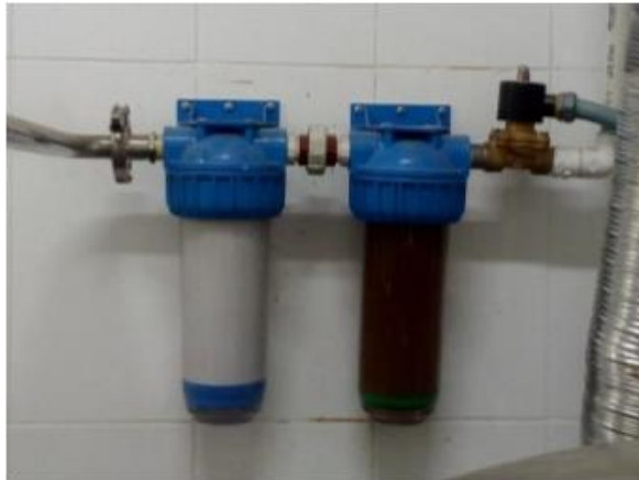
Figura 3. Filtros de agua utilizados en la Cervecería OD Colombia.
