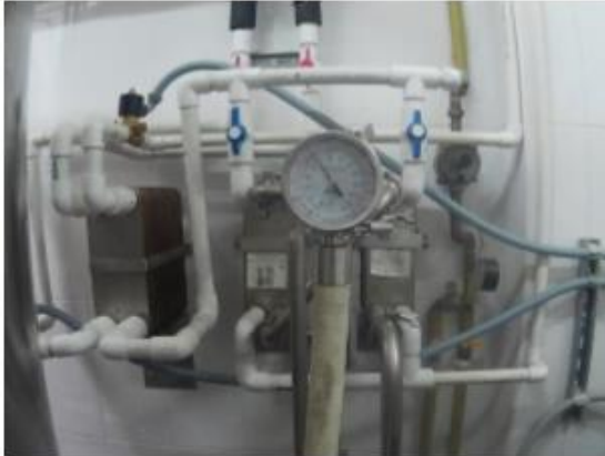
Figura 13. Línea de intercambiadores de calor.
