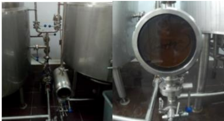
Figura 10. Bomba centrífuga y deposito pulmón para recirculado.
