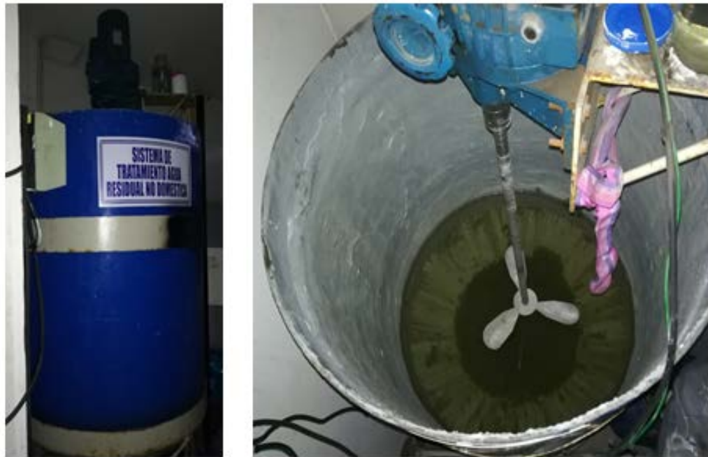
Figura 3 Planta de Tratamiento de agua residual industrial ANALQUIM LTDA
