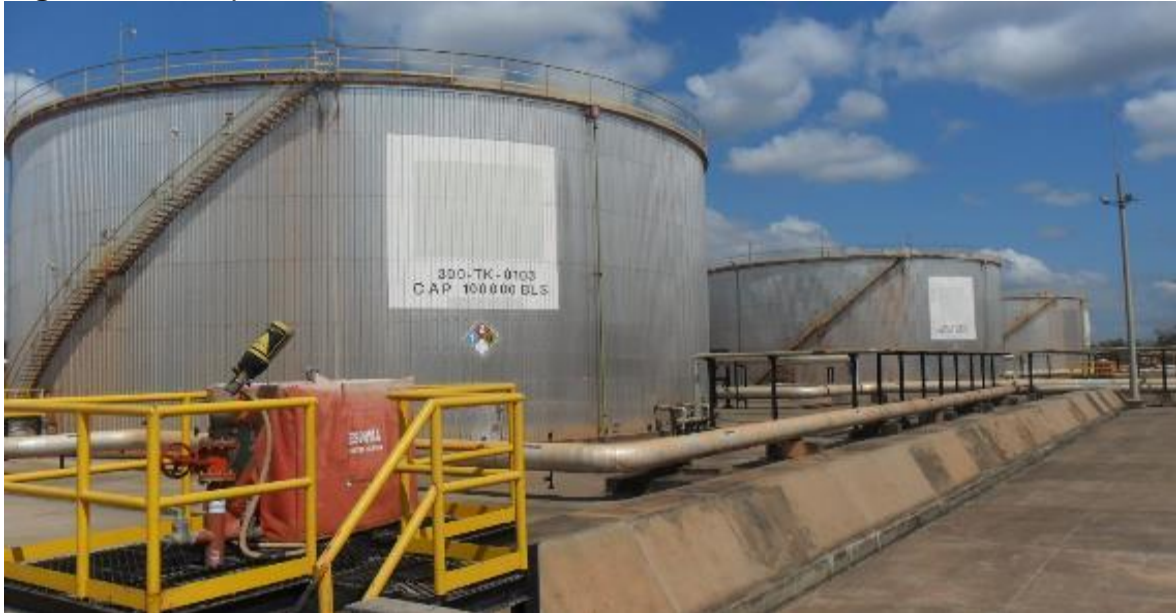
Figura 21. Tanques de Almacenamiento, CPF-B.
