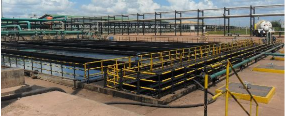
Figura 25. Piscina de retro lavado, CPF-B.
