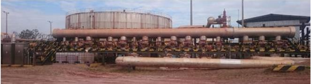
Figura 3. Manifold ampliación 100K, CPF-A.
