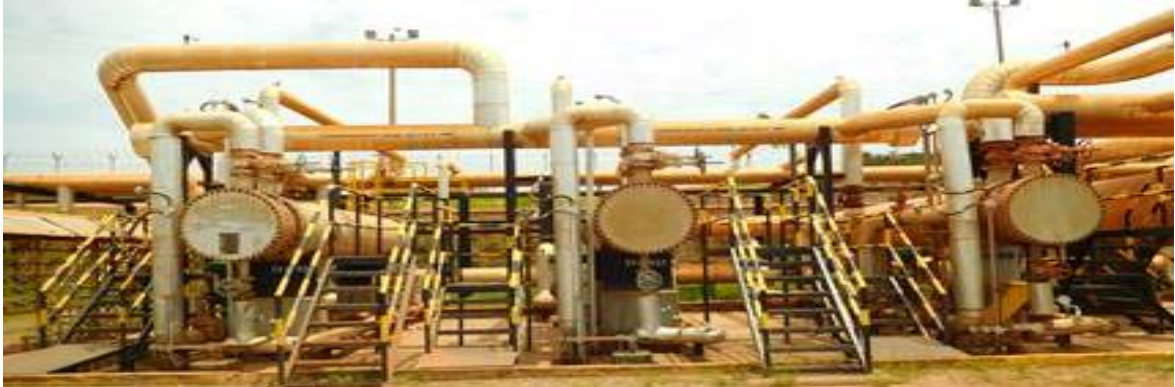
Figura 6. Intercambiadores de calor crudo-vapor CPF-A.
