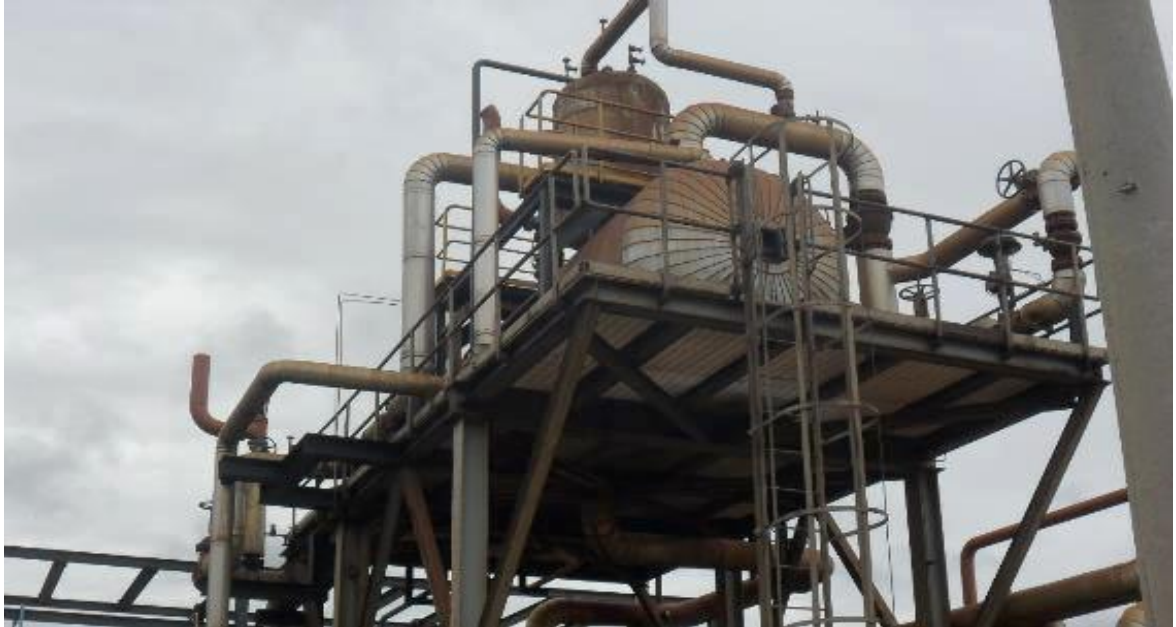
Figura 19. Tanque Flash y Desaireador, CPF-B.
