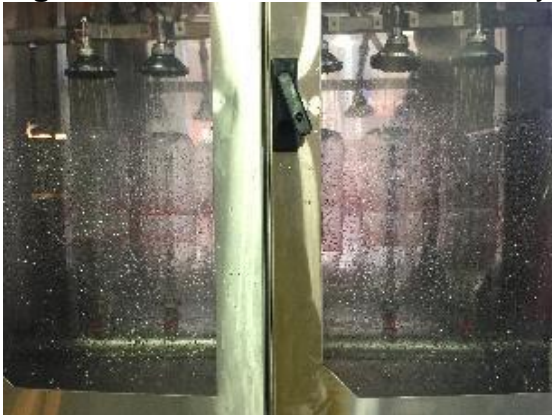
Figura 14. Duchas de lavado interno y externo de la Ref PET
