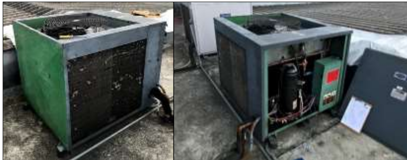
Figura 45. Estado actual de la unidad condensadora (UCI)
