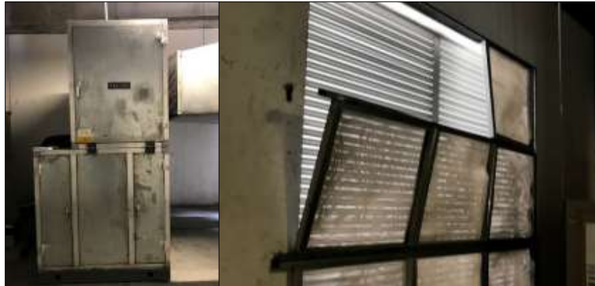
Figura 30. Unidad manejadora y paños en ventanas
