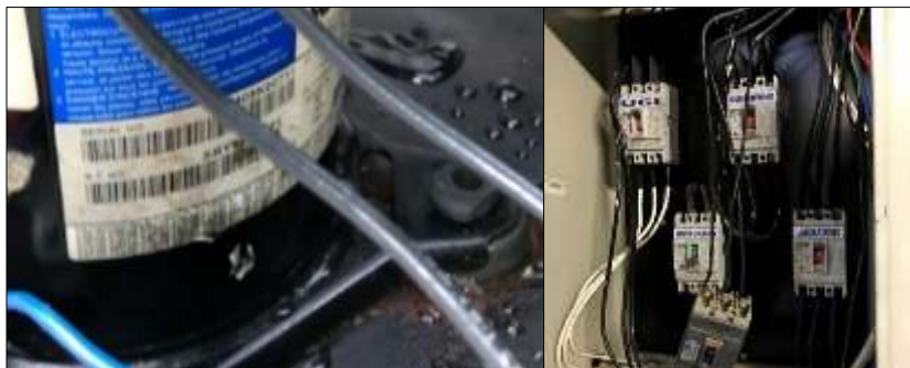
Figura 48. Elementos del sistema de climatización (UCI)
