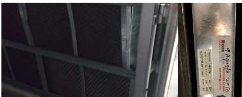
Figura 33. Sistema de filtros en la unidad manejadora de aire
