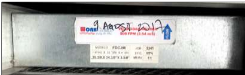
Figura 66. Estado actual de los filtros en UMA neonatos
