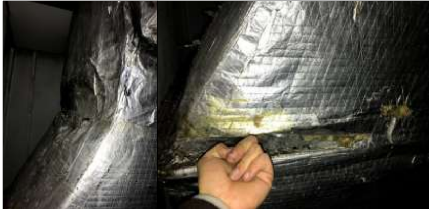
Figura 84. Estado actual de ducto de impulsión a imagenología
