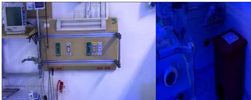
Figura 58. Accesorios en el interior de cubículos de neonatología
