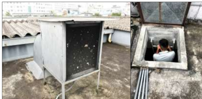
Figura 29. Ductos de extracción del quirófano y compuertas
