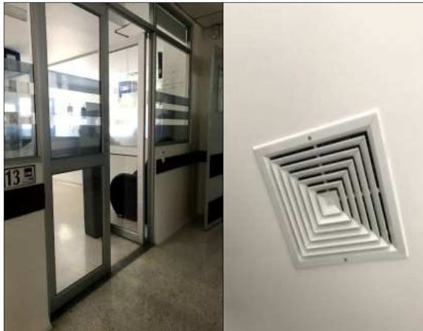
Figura 44. Puertas de acceso a cubículos e inyección de aire
