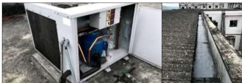
Figura 27. Unidad condensadora del quirófano y acceso cubierta
