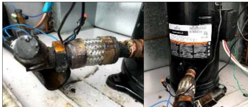
Figura 81. Interior unidad condensadora y accesorios
