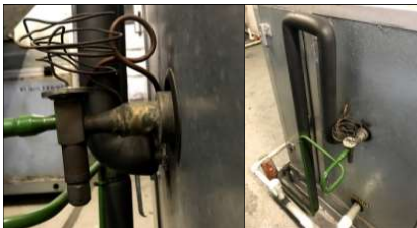
Figura 51. Estado actual de elementos de la unidad manejadora
