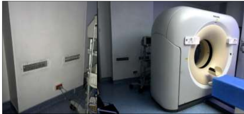
Figura 71. Rejillas extracción de aire y equipo de diagnóstico
