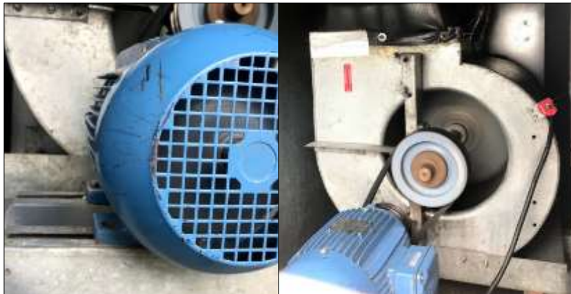
Figura 64. Ventilador de unidad manejadora de neonatología
