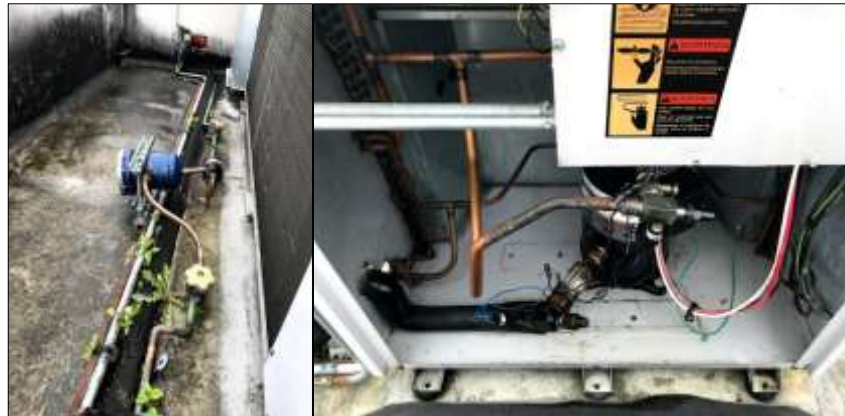
Figura 80. Interior de unidad condensadora imagenología
