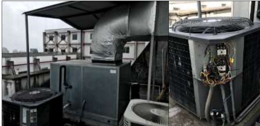
Figura 61. Estado actual de los equipos de neonatología
