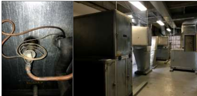
Figura 31. Válvula de expansión y cuarto de equipos
