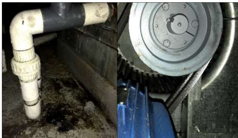
Figura 52. Estado actual del interior de la unidad manejadora
