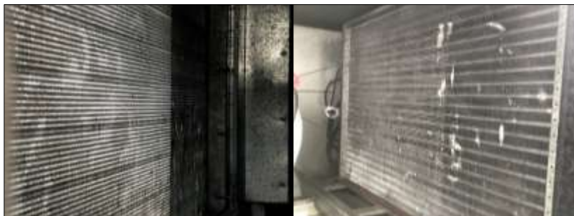
Figura 65. Evaporador de la unidad manejadora
