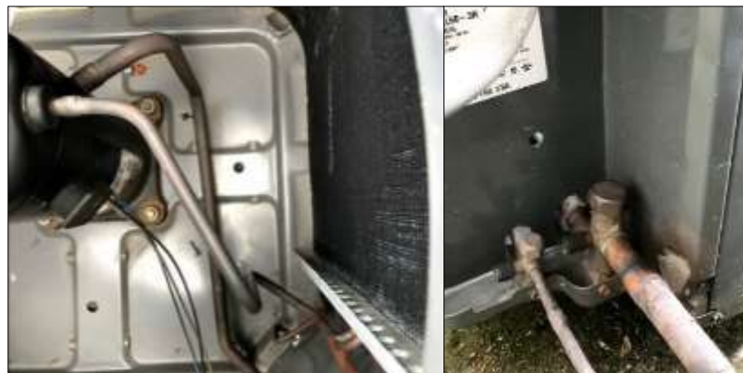
Figura 62. Unidad condensadora (interior) y valvulas de servicio
