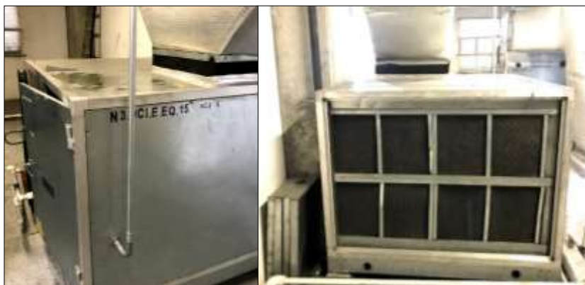
Figura 49. Estado actual de la unidad manejadora (UCI)
