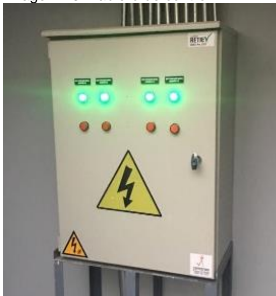
Imagen 73. Tablero de control.
