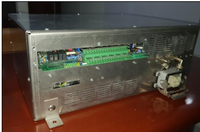
Imagen 31. Fuente de poder suministrada por IEPF S.A.S
