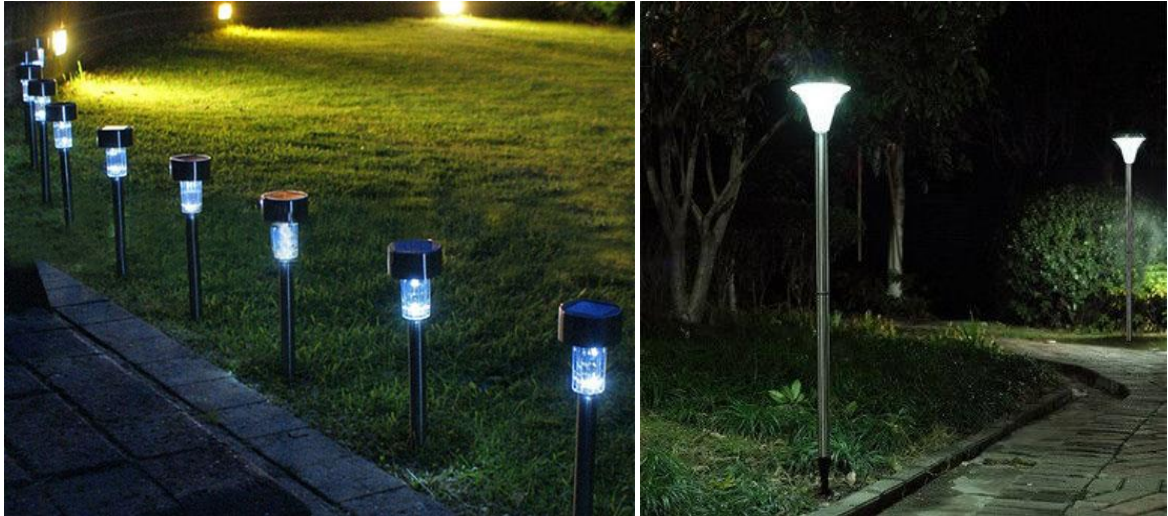
Figura 25. Luces con paneles solares
