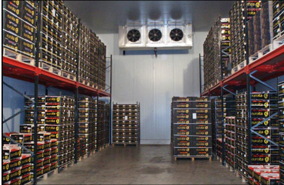
Imagen 40. Espacio interno de un cuarto frío.
