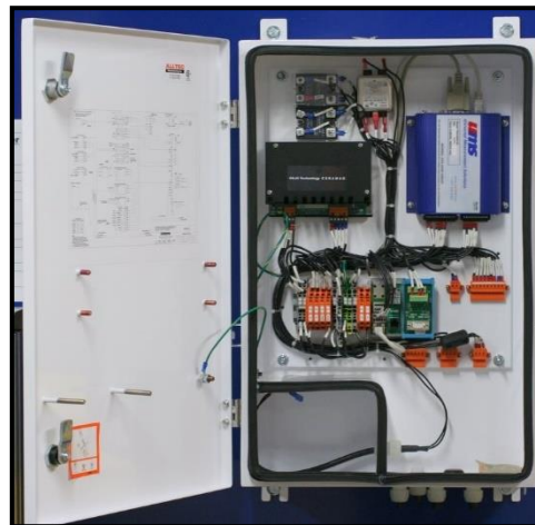
Imagen 7. Caja de comunicación en sitio.
